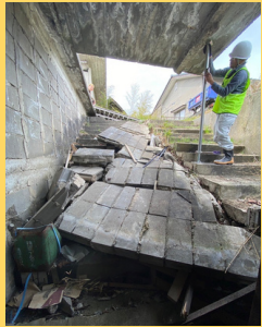
倒壊したブロック塀 (羽咋郡志賀町)
